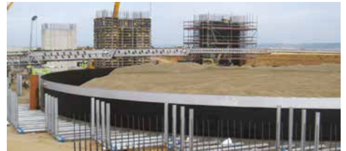
Central Termosolar Mérida, Córdoba
