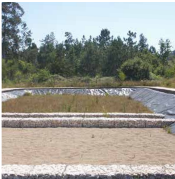
AT7 WWTP, Figueira da Foz
