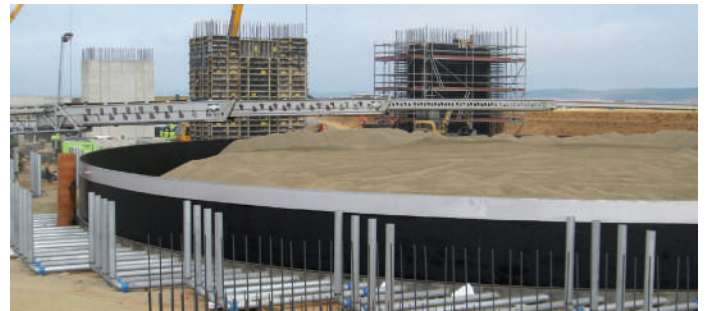
Central Termosolar Mérida, Córdoba
