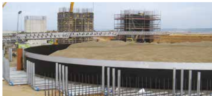
Central Termosolar Mérida, Córdoba
